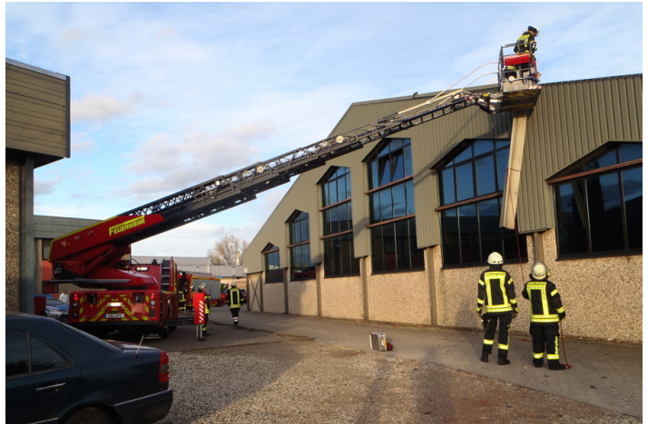
Die Feuerwehr sichert das Dach der ehemaligen Tennishalle an der Karlsruher Straße.
