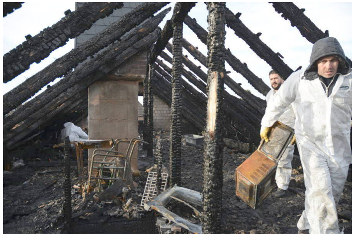
Die Aufräumarbeiten haben begonnen: Im Dachgeschoss ist durch das Feuer alles zerstört worden.
