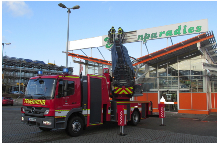
Die Einsatzkräfte montieren die Leuchtreklame am Baumarkt ab, um weiteren Schaden zu verhindern.
