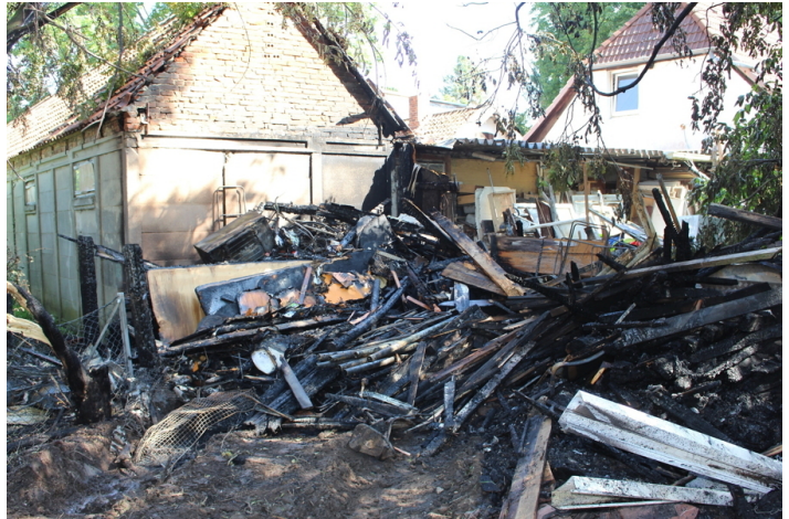
Vom Lagerschuppen bleiben nach dem Brand nur noch verkohlte Überreste
