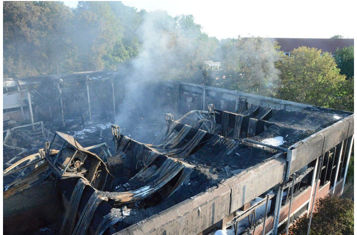
Das Dach ist eingestürzt, um 20 Uhr brennen immer noch einzelne Glutnester.
