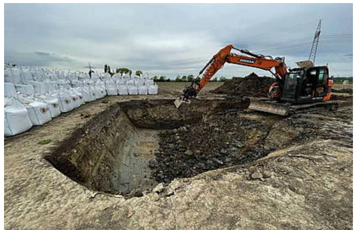
In etwa fünf Metern Tiefe lag der fünf Zentner schwere Blindgänger aus dem Zweiten Weltkrieg. /
