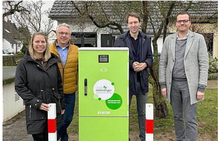
Referent des Kommunalmanagements Avacon Frank Glaubitz (von links), Bürgermeister Jan Dingeldey, Geschäftsführer Netzgesellschaft Hemmingen Thomas Dietmar und Vivian Klein, Referentin Elektromobilität Avacon, bei der Inbetriebnahme der E-Ladesäulen. /
