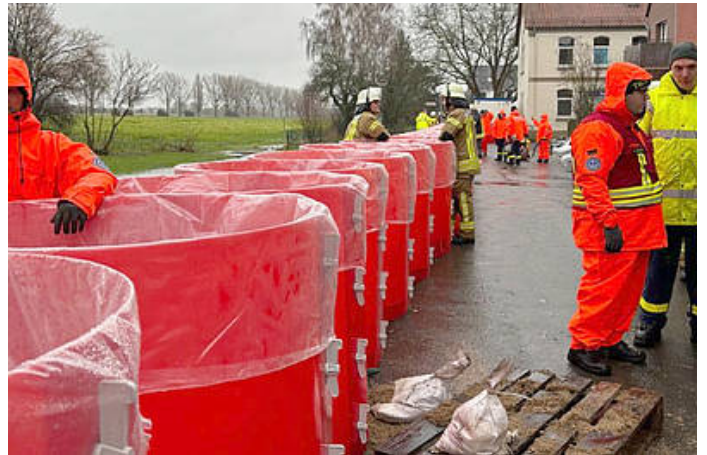
Im Bereich der Wiesenstraße, Schützenstraße und Brickelweg wird das Hochwasserschutzsystem Aquariwa vorsorglich aufgebaut. /
